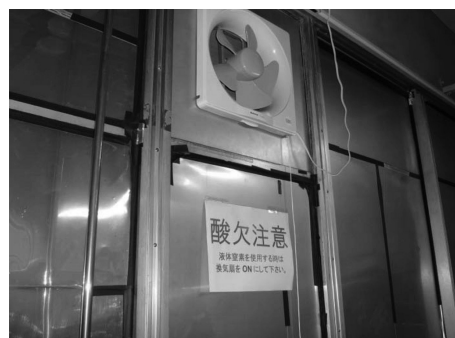
換気扇と注意を促す看板の設置
